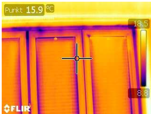
Termogramy IR_404 oraz 406 Pomieszczenie piętrowe 2.5 – okno. Widoczny mostek termiczny w miejscu osadzenia okna na styku z podłogą oraz u góry okna
